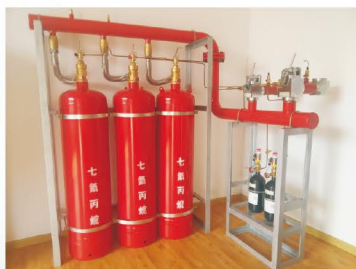
七氟丙烷气体灭火系统
