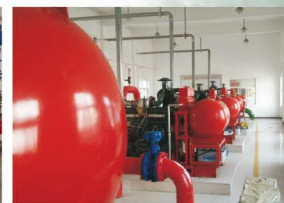
中石化河北沧州油库
