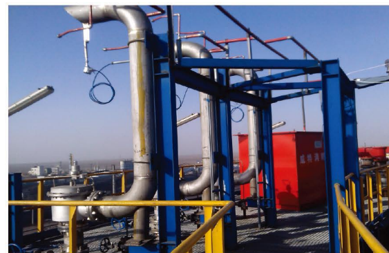
内蒙西来峰LNG项目干粉灭火装置
