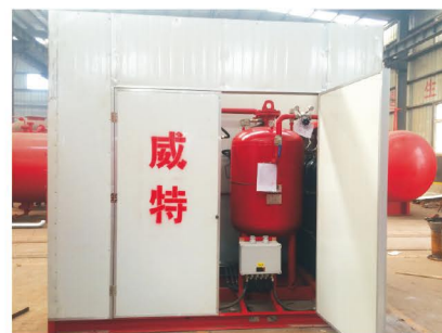
晋城华港燃气有限公司沁水煤层气液化调峰储备中心干粉灭火装置
